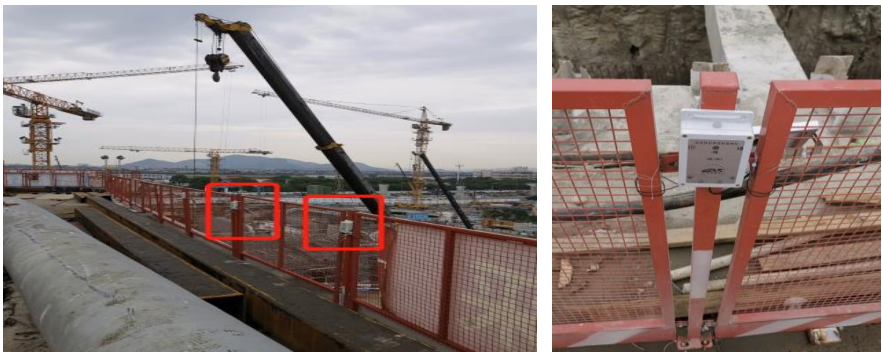
图 临边防护缺失报警系统现场图
