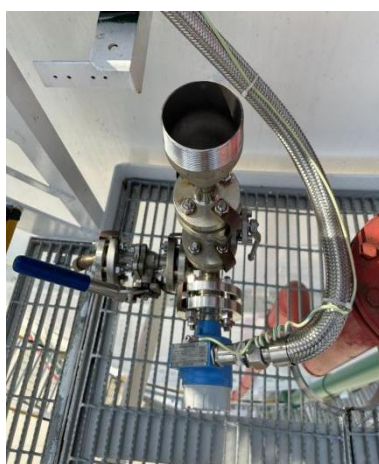
说明图 6.1.4-5 高高液位报警检测装置与泡沫产生器共用平台
