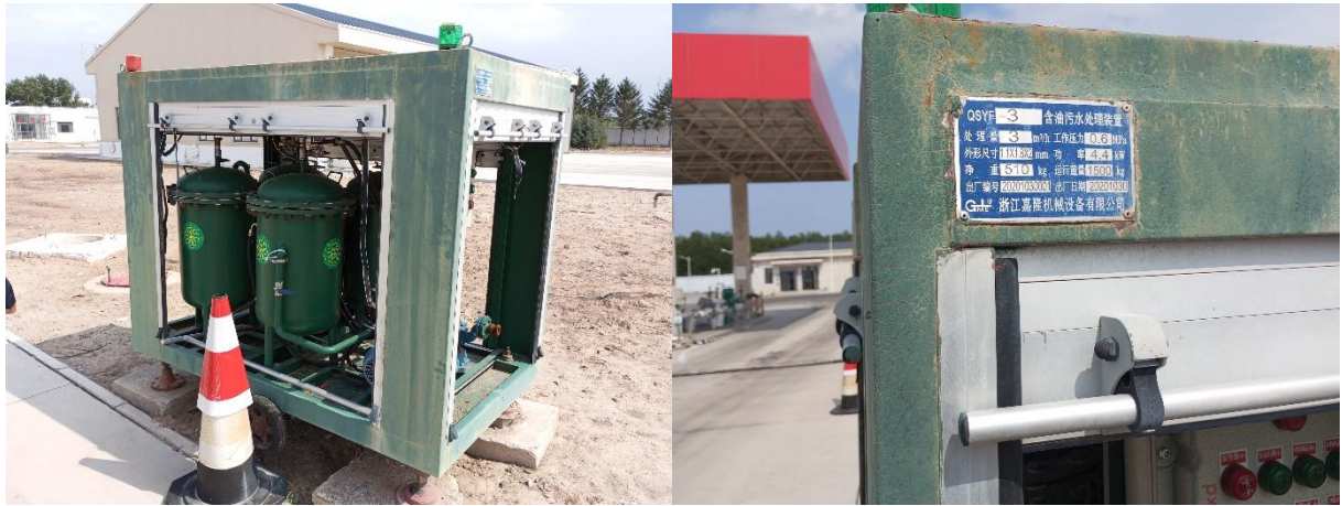
说明图 10.3.6-1 含油污水处理装置
