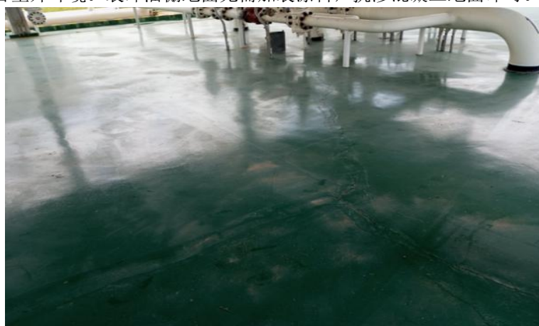
说明图 9.1.4-4 装卸油棚自流平裂纹
