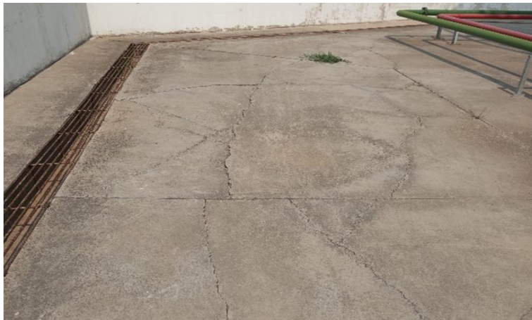
说明图 5.1.5-1 抗渗混凝土开裂
