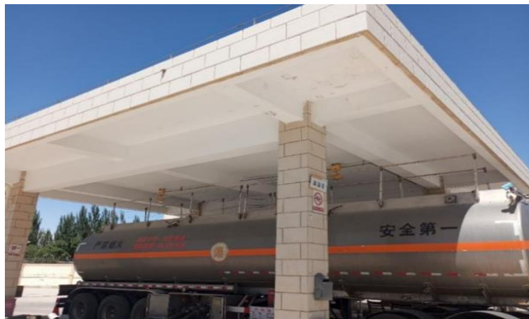
说明图 9.1.4-1 装卸油棚棚顶低，不方便罐顶作业
